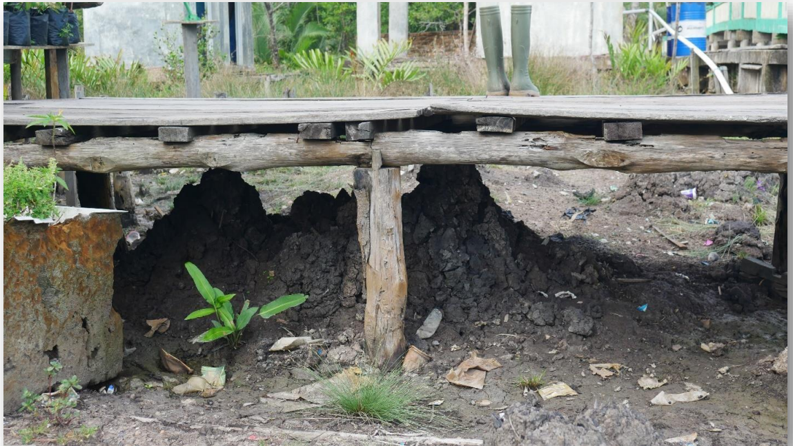
Gambar Kerusakan Akibat Hama
